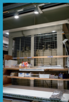
▲暗くなりがちな倉庫内。ダクトレールを使用し、欲しい位置に照明を設置。
